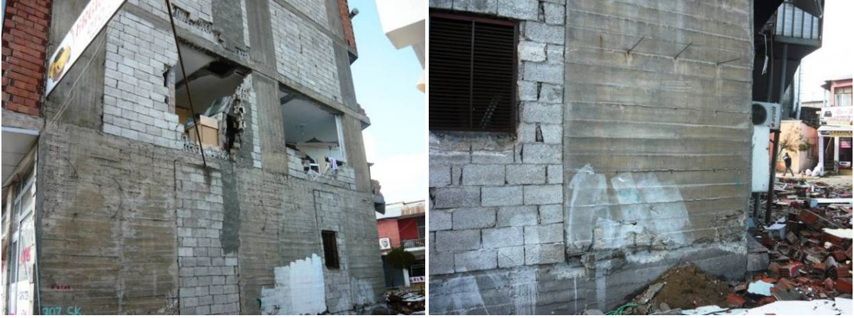
Şekil 5.24. Taşıyıcı sistemi düşeyde düzensiz orta hasarlı betonarme yapı
