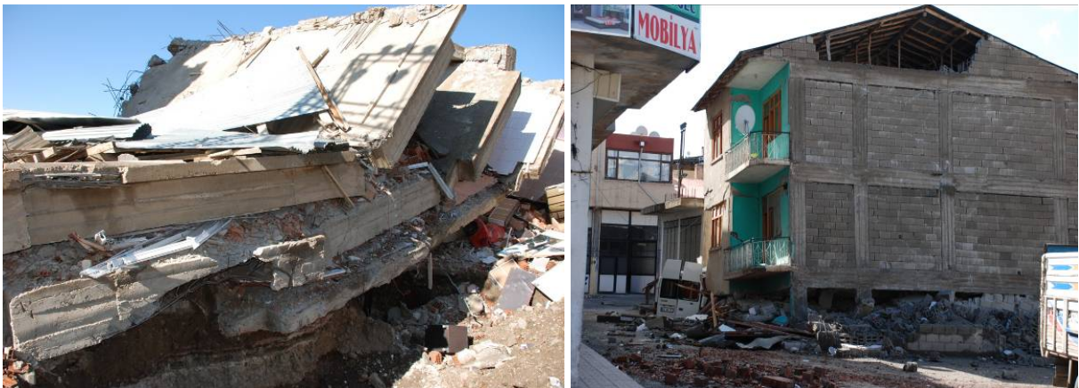
Şekil 5.31. Projesinde bodrum katın yerinde yapılmaması ve temelin yumuşak zemine oturtulması
