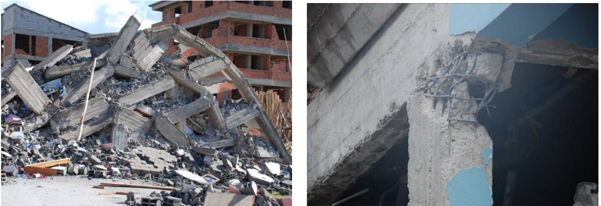
Şekil 5.33. Kuvvetli kiriş-zayıf kolon oluşumu
