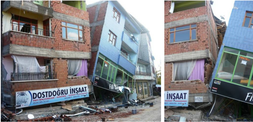
Şekil 5.23. Çekişleme etkisi ile birbirine çarparak ağır hasar görmüş betonarme yapılar
