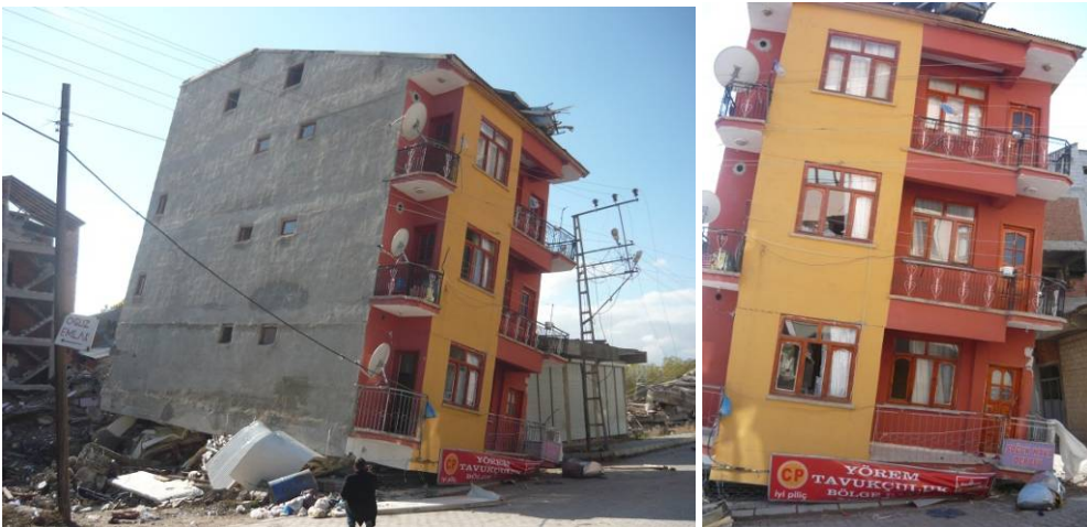
Şekil 5.27. Yumuşak kat oluşumu sonucu kat kaybı ile ağır hasara uğrayan betonarme yapı
