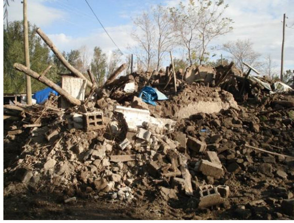
Şekil 5.3. Depremde göçen yığma yapı enkazı
