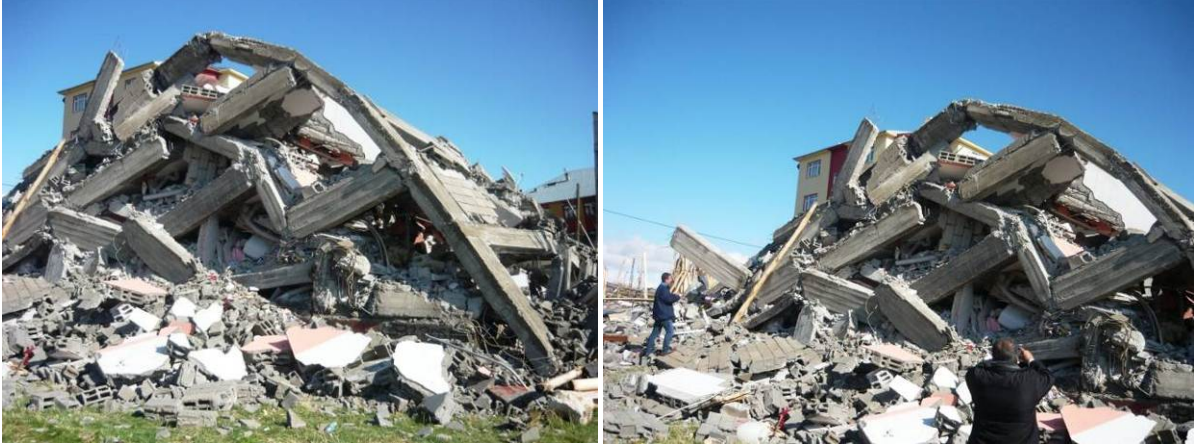
Şekil 5.26. Tamamen yıkılmış betonarme çok katlı yapı
