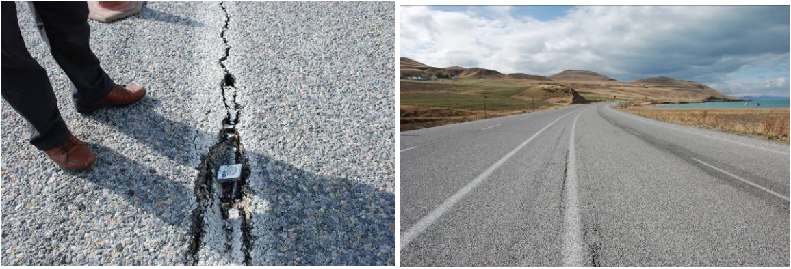
Şekil 4.13. Van Erciş karayolu üzerinde meydana gelen heyelan
