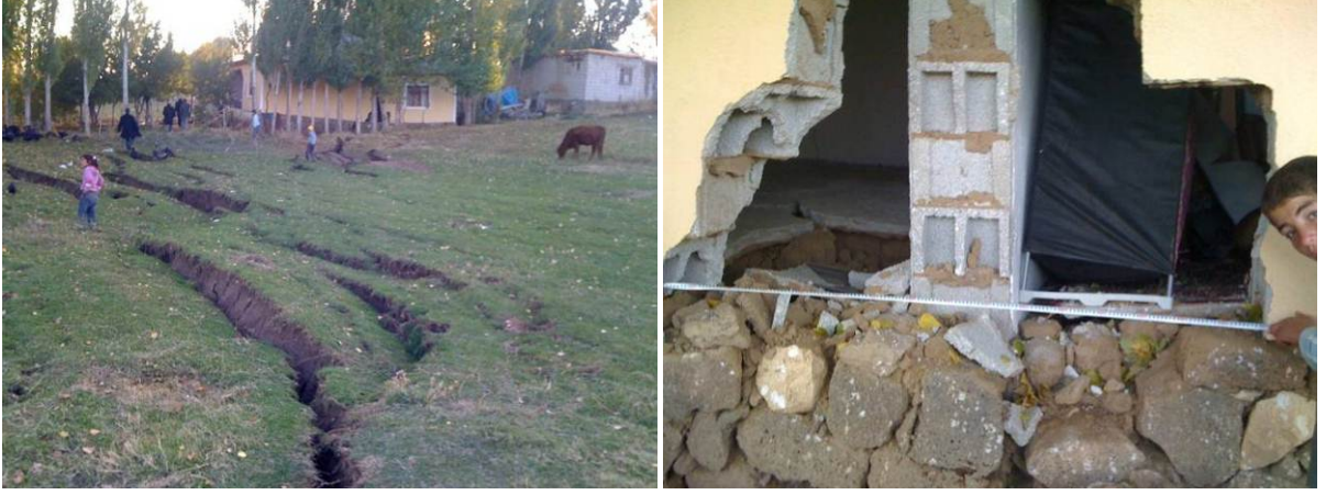
Şekil 5.17. Depremin tetiklediği yüzey ayrılması oluşumu ve ayrılma üzerinde kalan yapıda oluşan 1.50 m’lik yarılma
