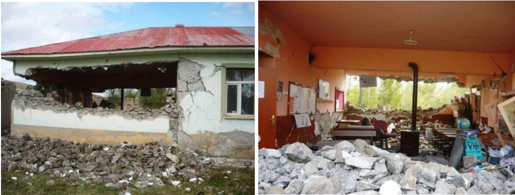
Şekil 5.39. Göllü köyünde ağır hasarlı ilköğretim okulu
