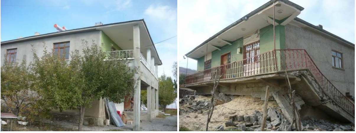
Şekil 5.41. Göllü köyünde hasar görmeyen iki katlı betonarme yapı ile alt katı göçen betonarme yapı
