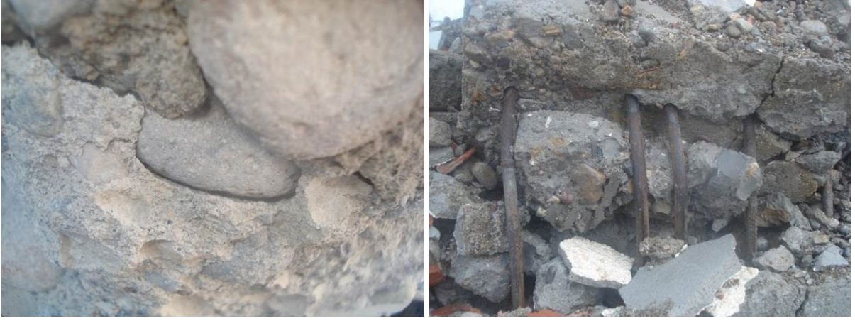
Şekil 5.9. Çimento hamuru-agrega arayüz çatlağı ve betondan sıyrılan düz inşaat çeliği
