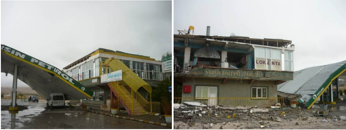
Şekil 5.12. Yıkılan benzin istasyonu kanopisi ve ağır hasarlı tesis
