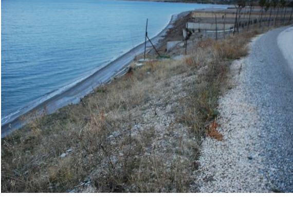
Şekil 4.12. Dağönü Köyü'ne ulaşım sağlayan yol boyunca meydana gelen heyelan
