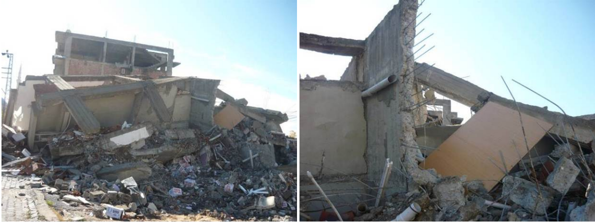
Şekil 5.19. Yanal ötelenme ve burulma katkısı ile göçme mekanizması oluşmuş yapı
