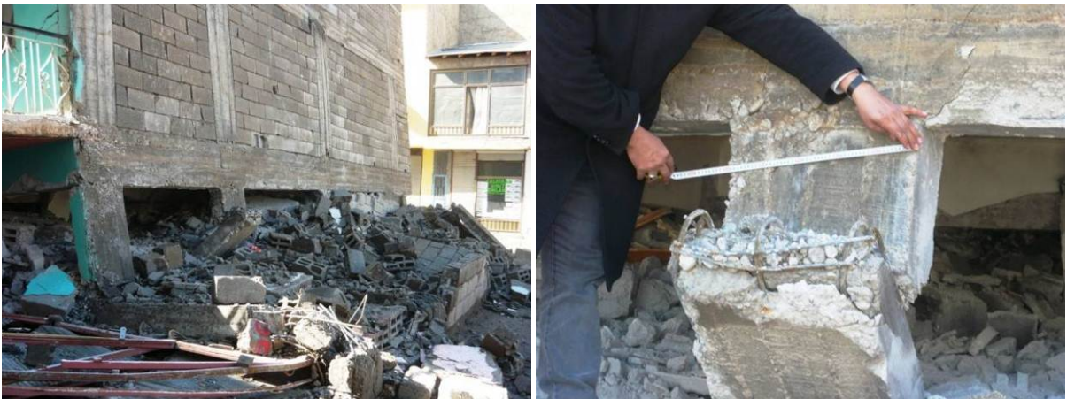
Şekil 5.25. Depremde zemin katı yanal hareket sonucu ağır hasar gören betonarme yapı
