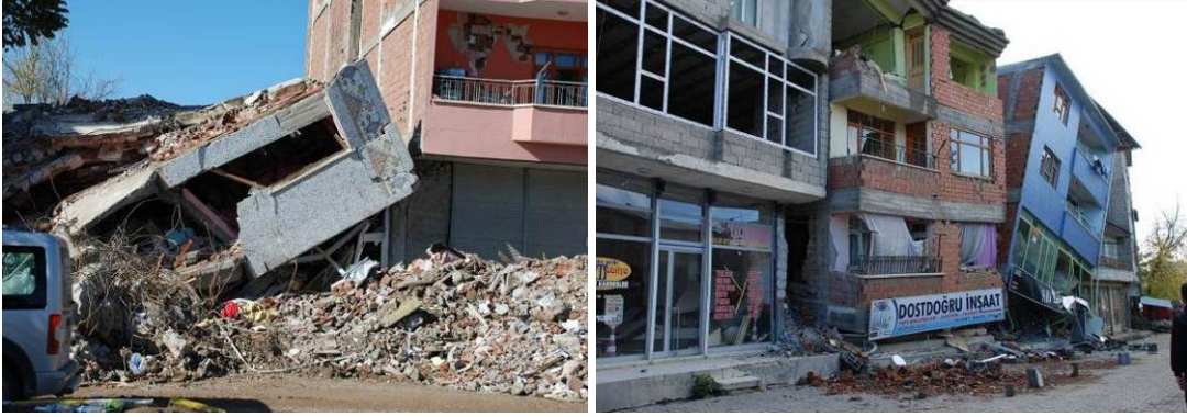
Şekil 5.38. Çekiçleme etkisi sonucu oluşan hasarlar
