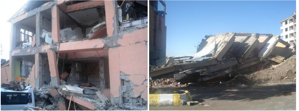
Şekil 5.2. Ağır hasarlı ve enkaz haline gelen betonarme karkas binalar
