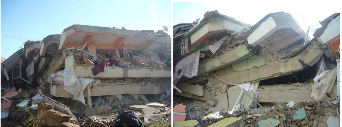
Şekil 5.18. Yanal ötelenme ve burkulma katkısı ile göçme mekanizması oluşturmuş yapı
