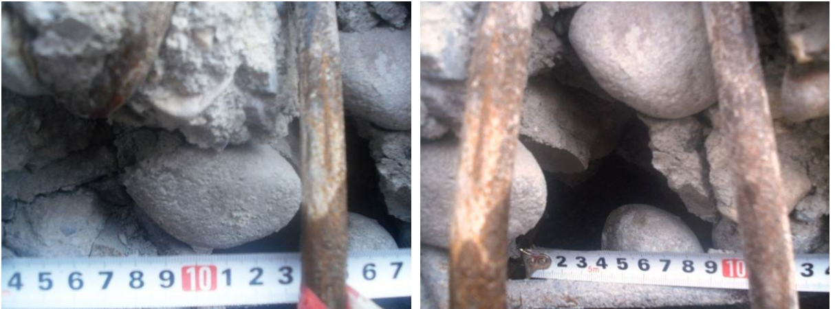
Şekil 5.8. Betonda kullanılan iri malzeme ve yerleştirme problemleri
