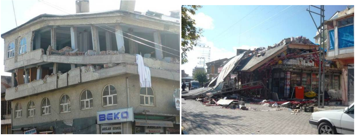
Şekil 5.22. Ara kat göçmesi ve üst kat göçmesi gözlenen betonarme yapılar
