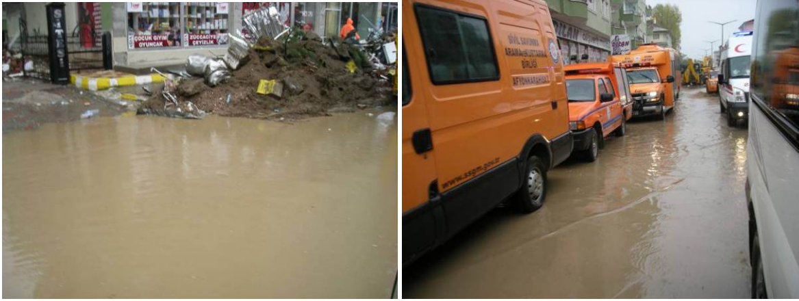
Şekil 5.56. Yağmur suyu kanalizasyon hattının yerüstüne yansıyan durumu
