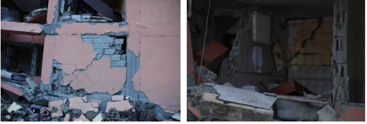
Şekil 5.36. Dolgu duvar hasarları
