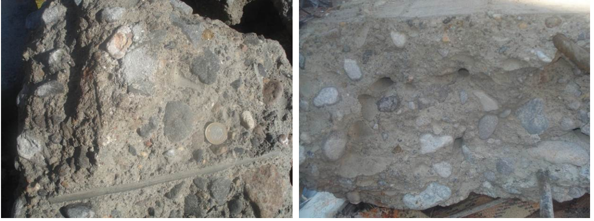
Şekil 5.7. Enkazdan görüntülenen beton kesitleri
