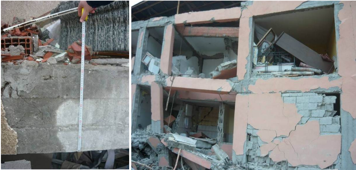
řekil 5.14. Van Yolu Caddesinde yer alan ağır hasarlı yapı
