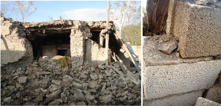
Şekil 5.10. Kırsal kesimdeki yapı hasarları ve bağlayıcısı uygun olmayan bir yığma yapı detayı
