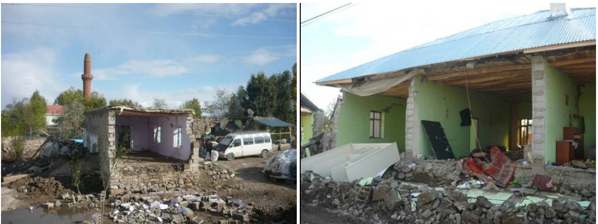
Şekil 5.42. Güveçli köyünde ağır hasarlı briket yığma yapılar ile külahlı düşen minare
