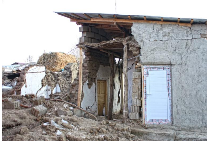
Fotoğraf 2- Van'da Geleneksel Yapı Kurallarına Aykırı Yapılmış Hasarlı ve Kimliksiz bir Ev
